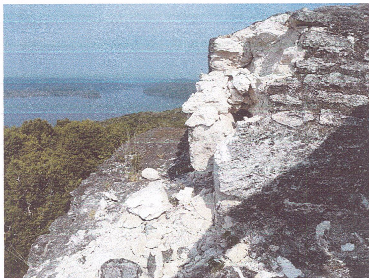
Fig. 3. Esquina sureste impactada por descarga eléctrica sucedida el 03 de mayo del presente año; nótese desintegración de material, tanto de piedra caliza y mortero de unión.
